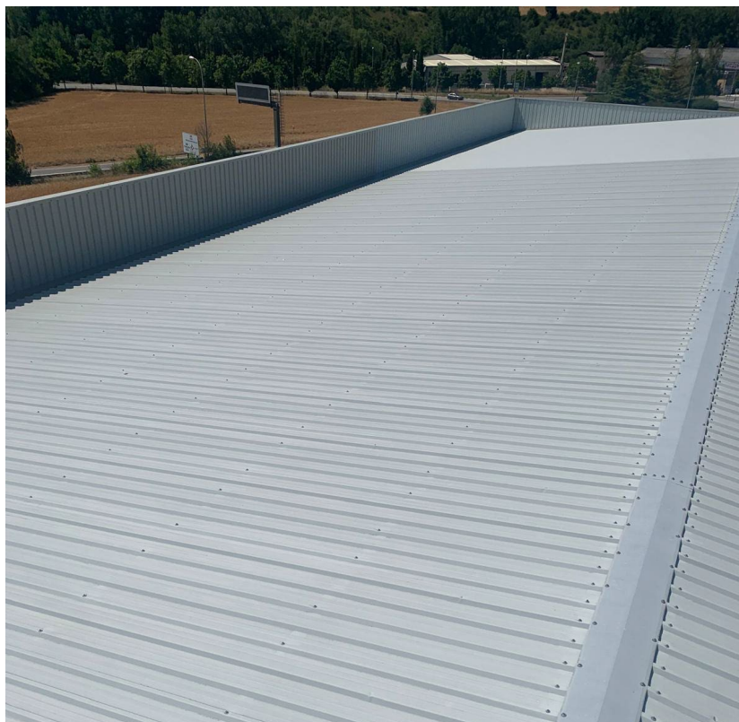
Detalle de faldón de cubierta de chapa simple, con numerosos puntos de fijación cuyos elementos están deteriorados y presentan filtraciones al interior, al igual que a través de los encuentros con elementos singulares, en este caso cumbrera, y por holguras en solapes de las chapas.
