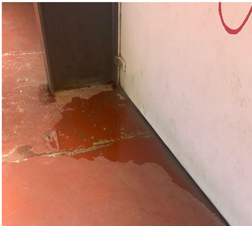
Detalle de filtración en otro punto del frontón
